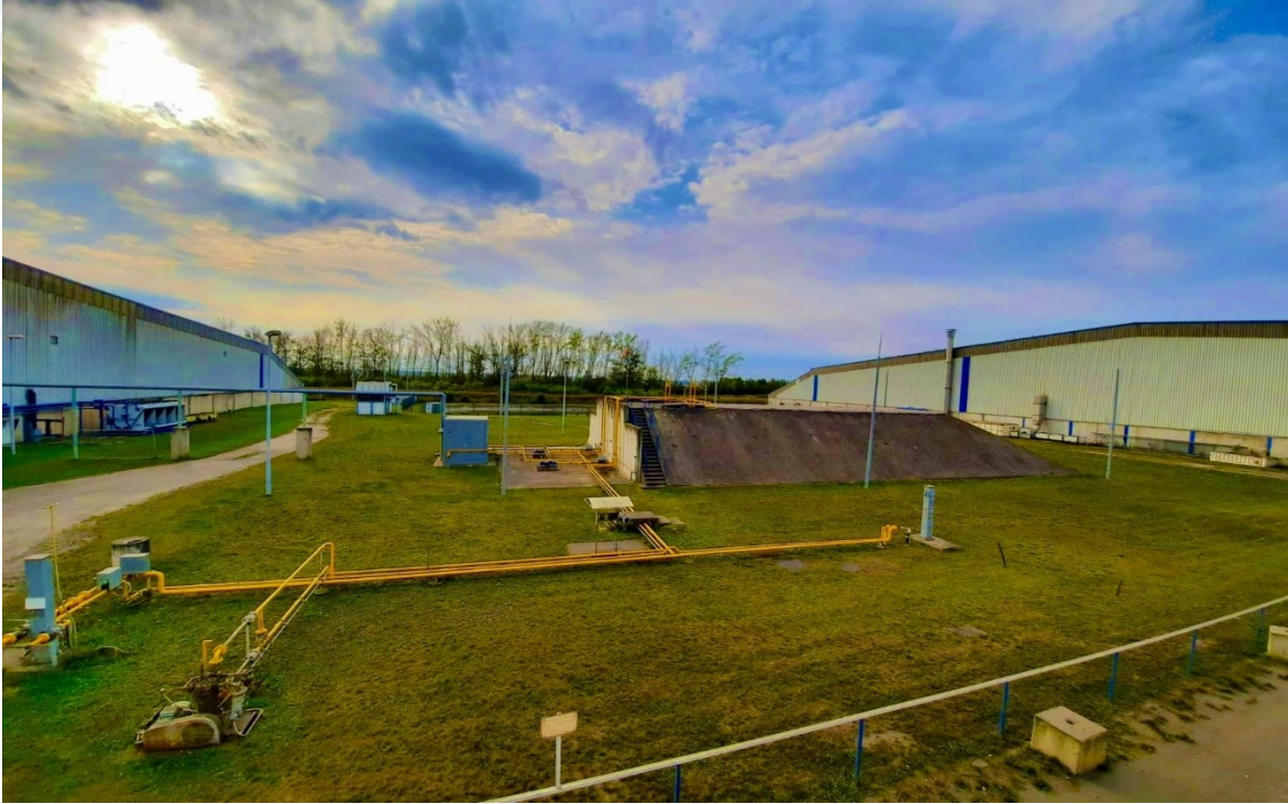
Gaslager mit erdbedeckten Stahlbehälter.
